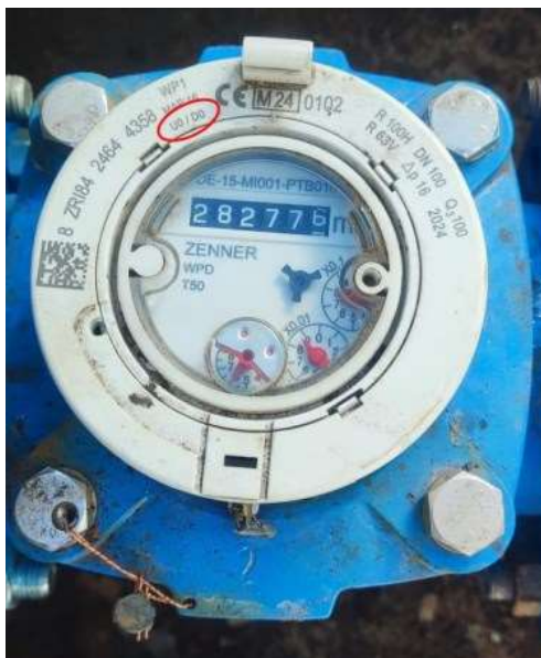
Ilustración 6. Captación n.º 1. Contador CHT. Certificado U0/D0.
