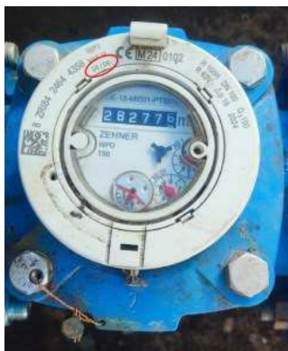
Ilustración 4. Captación n.º 1. Contador CHT. Certificado U0/D0.
