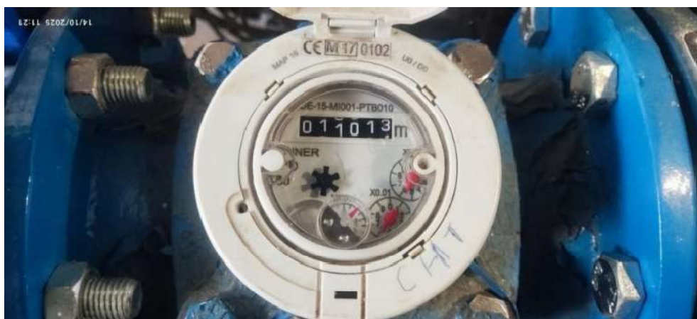
Ilustración 15. Captación n.º 4. Contador CHT.
