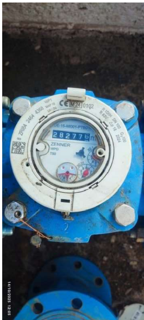
Ilustración 9. Captación n.º 1. Contador CHT.
