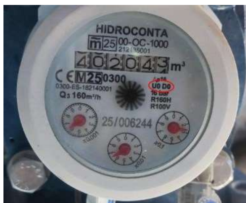
Ilustración 7. Captación n.º 1. Contador CARD. Certificado U0/D0
