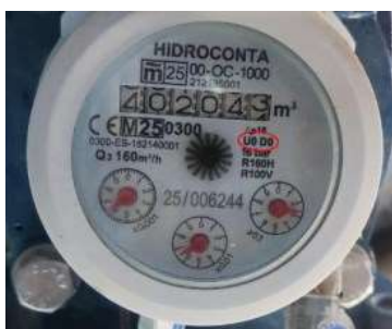
Ilustración 5. Captación n.º 1. Contador CARD. Certificado U0/D0
