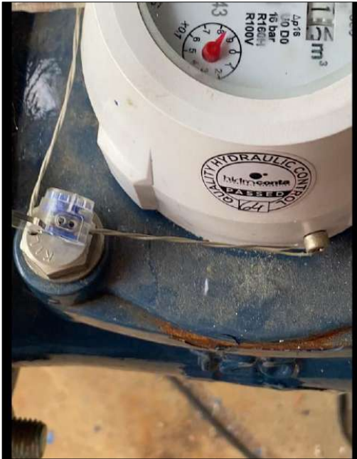
Fotografía 52 – Zoom del contador CARD del Pozo Nº4. Detalle de óxido.
