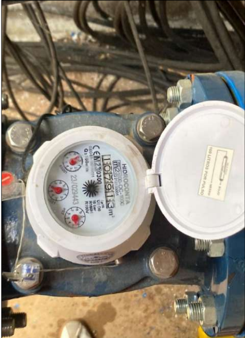
Fotografía 51 – Detalle contador HIDROCONTA del Pozo Nº4
