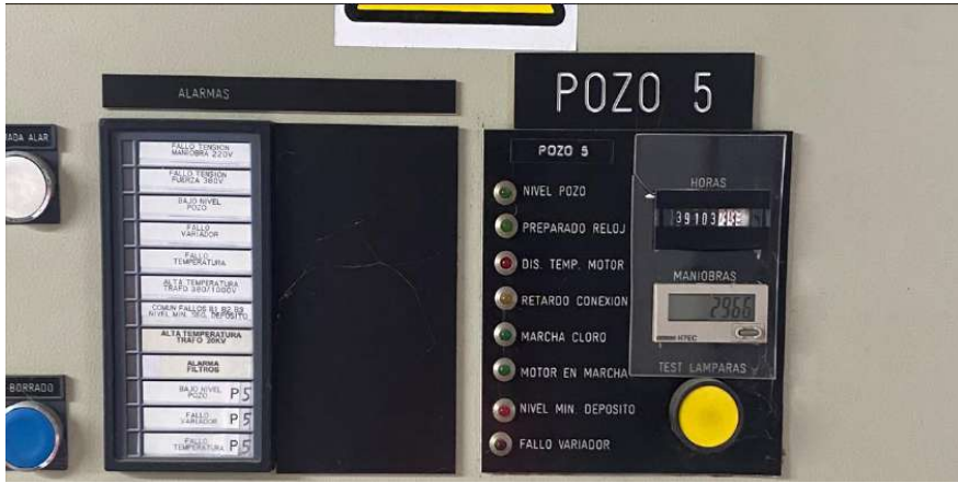
Fotografía 42– Zoom del Cuadro eléctrico del Pozo Nº5
